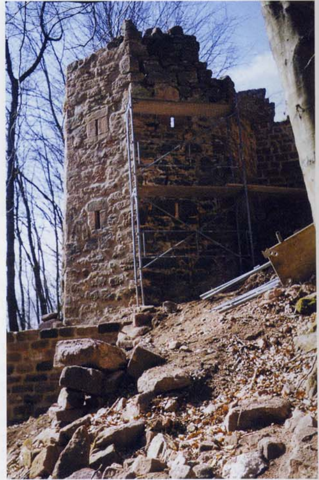
Schoeneck – Tour de flanquement Nord-Est en cours de consolidation par l'association "Cunulmergrun" (Photo M. Heissler)
